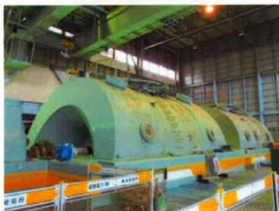
2号機低圧タービンの外観
