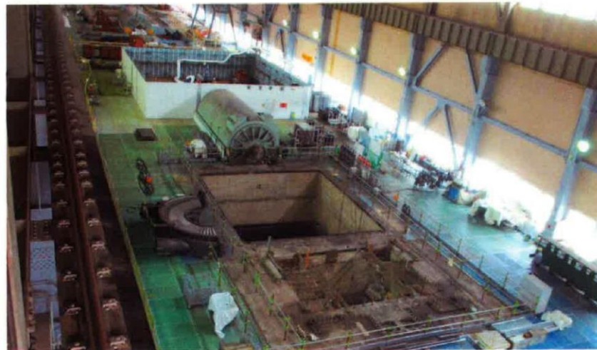
※手前は1号機の発電設備、奥は2号機
